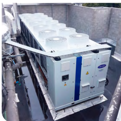
Le nouveau groupe froid de la clinique Sainte Marie, opérationnel depuis l’été 2025, permet de récupérer les calories produites pour chauffer l’eau sanitaire et modernise l’ensemble des installations techniques.
